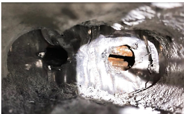
Figur 4: Delvis förstörande provning. Korrosionen framgår tydligt hos kablarna.
