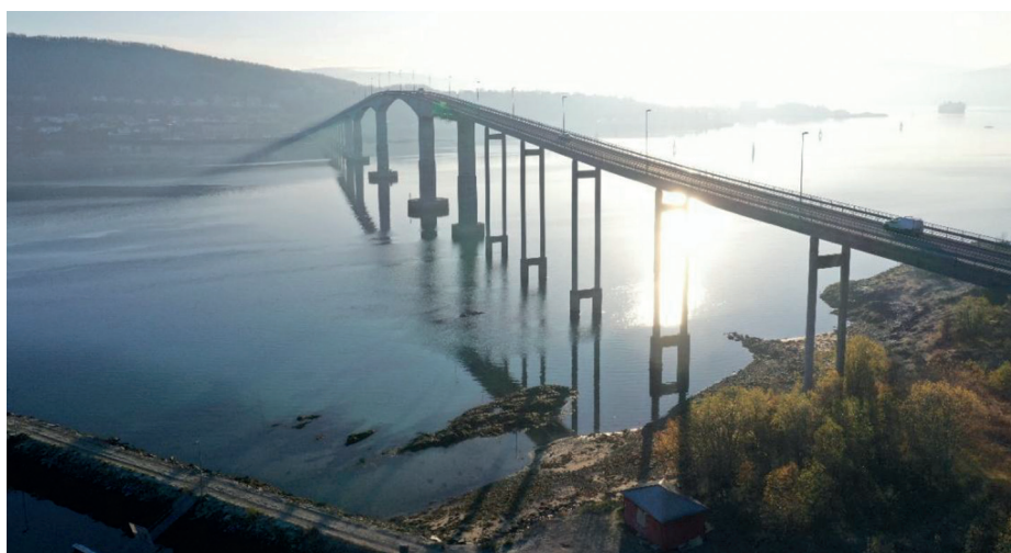
Figur 1: "Översiktsvy av en efterspänd betongbro (Gisund - Norge). Många nordiska broar från 1960-70-talen är betydelsefulla för regional trafik och närmar sig eller har redan passerat sin dimensionerande livslängd."
